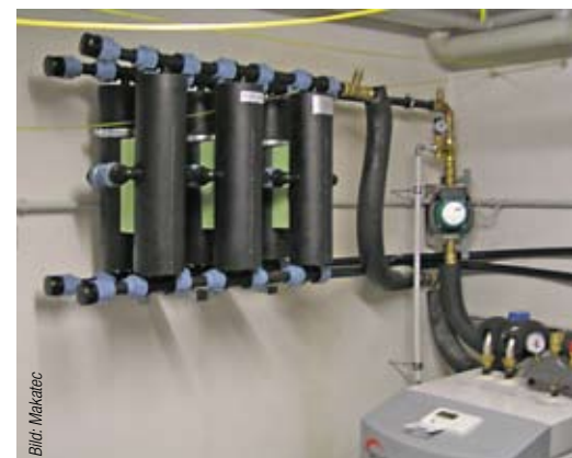
Makatec-Wärmeübertrager in einer Wärmepumpenanlage mit stark eisenhaltigem Grundwasser.
