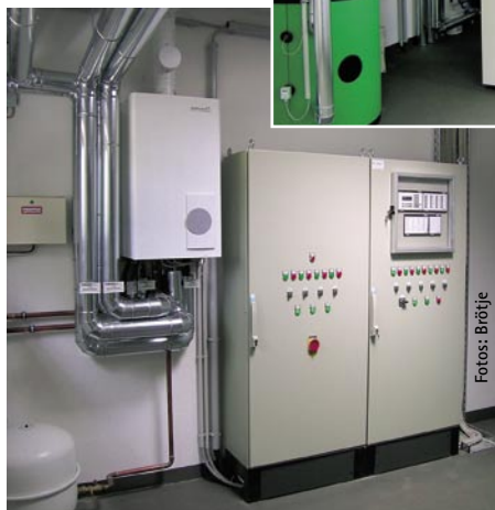
Brennwert-Kaskade von 9 bis 358 kW aus Ecotherm Plus WGB 2N zur Wärmegrundversorgung und Eurocondens SGB 2 für die Spitzenlast der Trinkwassererwärmung
