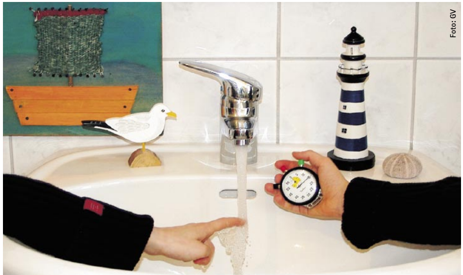
Bild 1 Nach aktueller Rechtsprechung muss nach 15s eine Temperatur von 40 °C an jeder Zapfstelle erreicht werden
