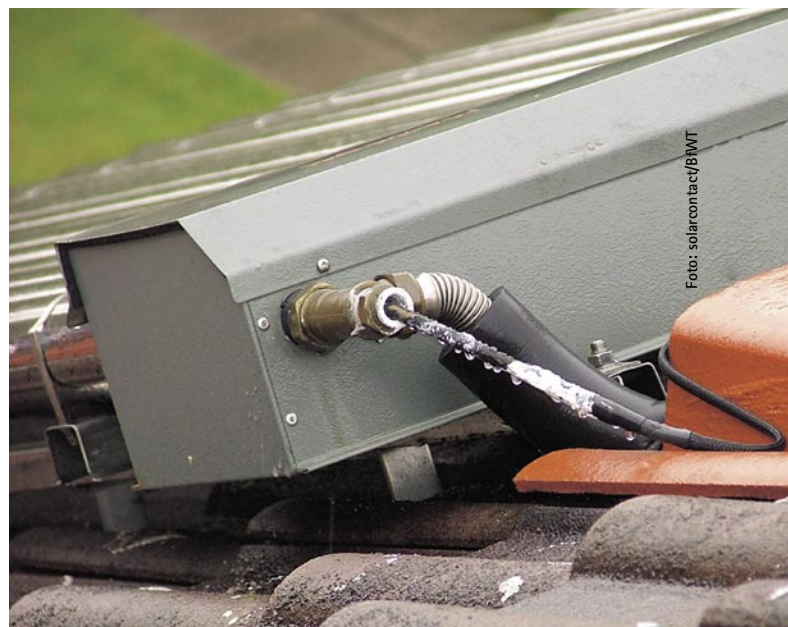
Bild 1 Unzureichende Befestigung des Fühlers bzw. des Kabels: Dieser Fühler meldet dem Regler einen richtigen Wert, der an falscher Stelle gemessen wird
