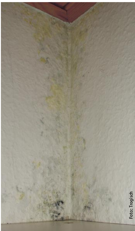
Bild 1 Schimmelpilz in Wohnungsecke in der Küche, wärmedämmte Außenwände
