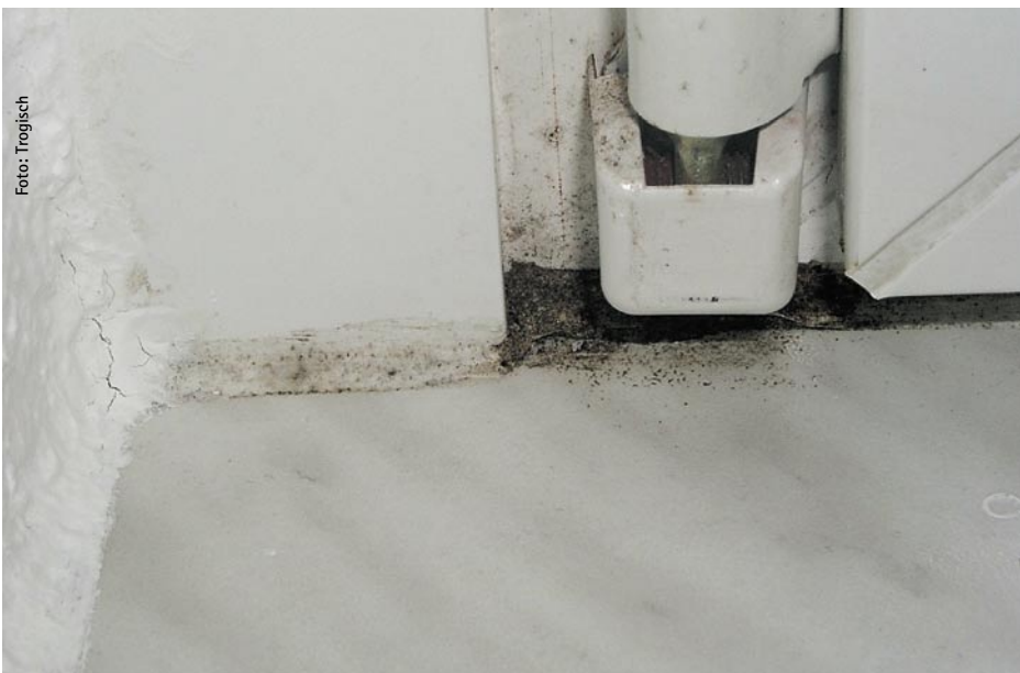
Bild 4 Schimmel am Fenstergewand und an der Silikonfuge Fenster/Fensterbank im Wohnzimmer
