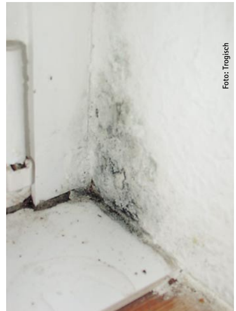
Bild 3 Schimmel am Fenstergewand in der Küche
