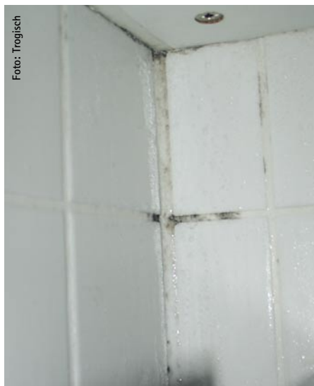
Bild 2 Wohnungsecke in der Küche: Schimmelpilz im Fugenbereich (unter Hängeschrank)
