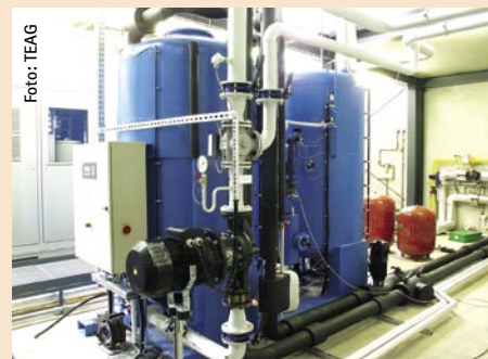
Integrierte Energiezentrale in der Zentralklinik Bad Berka/Thüringen mit einem MTU-Brennstoffzellenaggregat „Hot-Modul“ und direkt gekoppelter Absorptionskältemaschine
