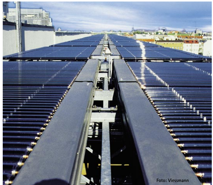
Vakuum-Röhrenkollektoren mit einer Absorberfläche von 240 m 2 sorgen für kühle Luft im Bundespresseamt
