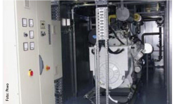
Biogas-BHKW. Durch den Nahwärmeverbund mehrerer Gebäude wird die notwendige Wärmeabnahme erreicht, um Erneuerbare Energien effizient und kostengünstig einzusetzen
