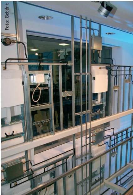
Der 6,5 m hohe und 7 m breite Trinkwasserturm stellt eine komplette Hausinstallation in einem Mehrfamilienhaus nach
