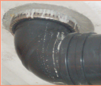
Phase I Temperaturen bis 300 °C (Auslösung der Brandschutz- manschette bei 180 °C)
