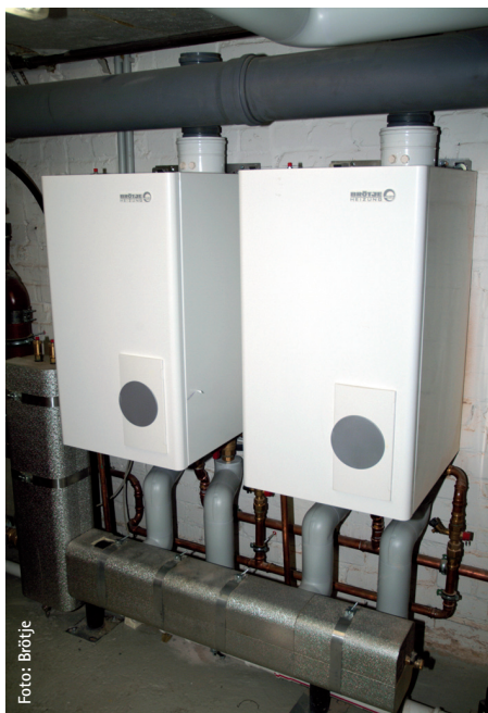
Bild 5 Sanierung eines Mehrfamilienhauses mit 24 Wohneinheiten mit zwei Gas-Brennwertheizkesseln als Kaskade mit 140kW
