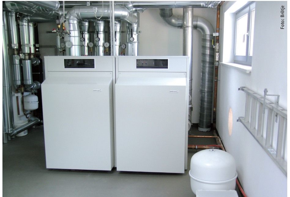
Bild 1 Heizzentrale mit bodenstehender Gasbrennwert-Kaskade mit insgesamt 360 kW
