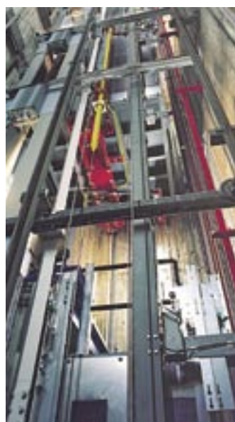
Technik im Aufzugsschacht
