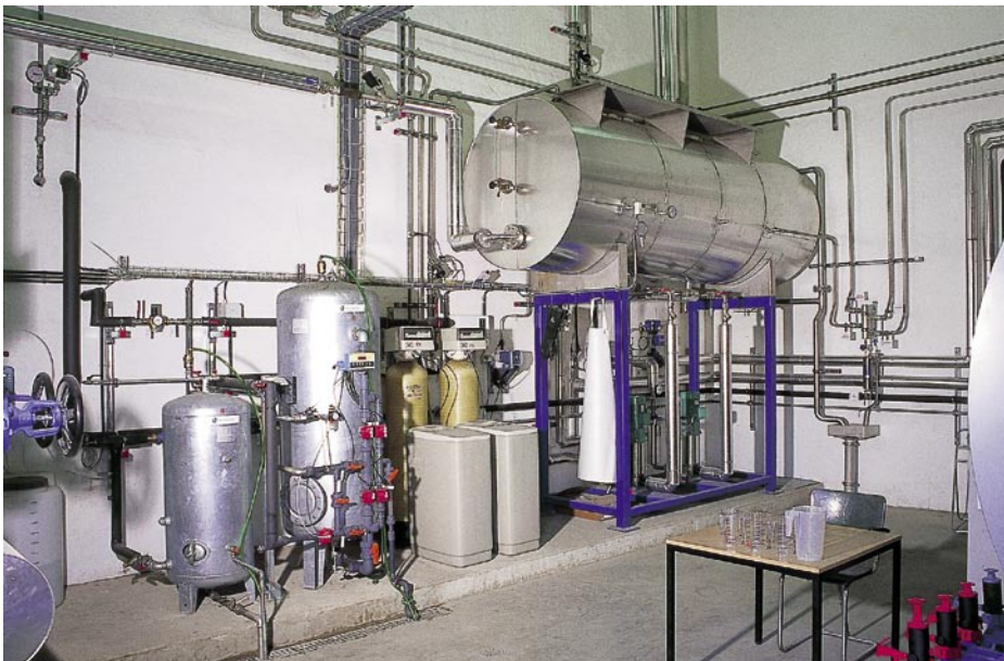
Bild 9 Anlage zur chemischen Wasseraufbereitung.
