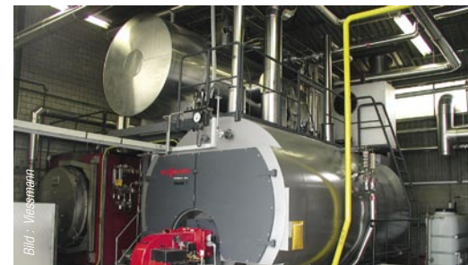
Bild 6 Speisewasserbehälter (oberhalb des Dampfkessels)
