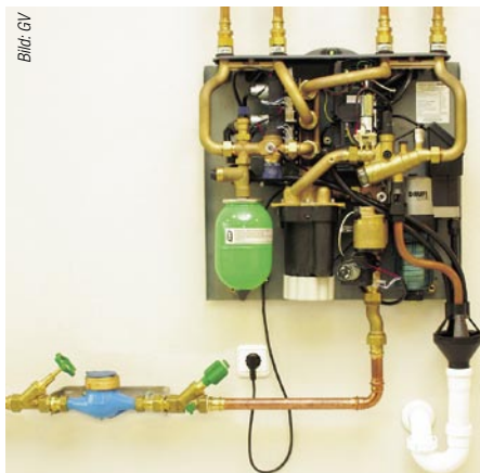
Regel- und Sicherheitszentrum RESI ohne Abdeckung: „Die komplette Hausinstallation auf einem Quadratmeter.“
