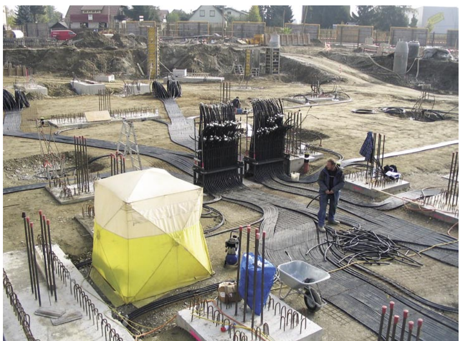
„Absorberbaustelle“. Grundvoraussetzung für einen reibungslosen Bauablauf ist die Montageplanung in Abstimmung mit dem Tiefbauunternehmen.
