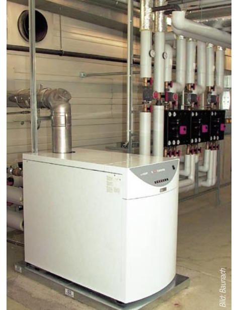
Brennwert-Kaskadenkessel ecoCraft in der Heizzentrale der Richter + Frenzel-Niederlassung Kassel
