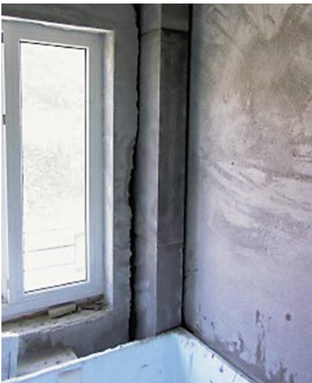
Bild 4 a) Montage einer nicht zugelassenen Abgasanlage mit HT-Rohren. Der Zuluftquerschnitt im Bereich der Deckendurchführung (Hüllrohr) ist zu gering. Es war eine Gipskartonverkleidung ohne Feuerwiderstandsdauer vorgehen.
