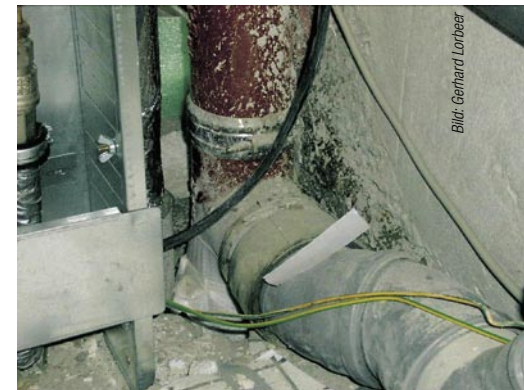
Bild 1 „Brandschutzlösung“ mit Fehlern.
