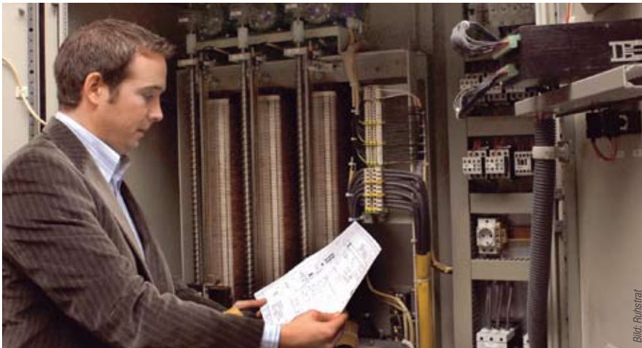
Eine DeltaVolt-Anlage wird zentral der Niederspannungshauptverteilung vorgeschaltet und hält die Spannung konstant auf niedrigem Niveau. Dadurch sinken Stromverbrauch und Energiekosten dauerhaft.
