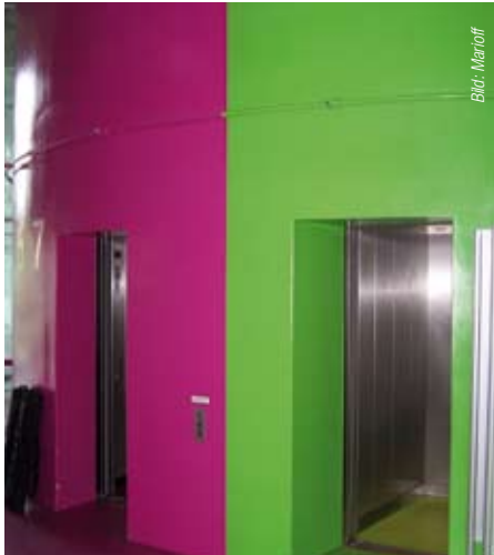
In Bereichen, wo Geschoss verbindende Decken fehlen, sieht das IKMZ-Brandschutzkonzept eine Kombination aus Hochdruck-Seitenwand- und hängenden -Deckensprinklern vor.
