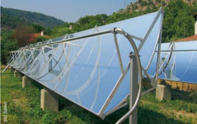
Einachsige nachgeführte Parabolrinnenkollektoren im Iberotel Sarigerme Park in Dalaman/Türkei zur Erzeugung von Heißwasser/Dampf für die Wäscherei, Küche und zur Trinkwassererwärmung sowie zur Erzeugung von Kälte mittels einer doppelstufigen Absorptionskältemaschine.
