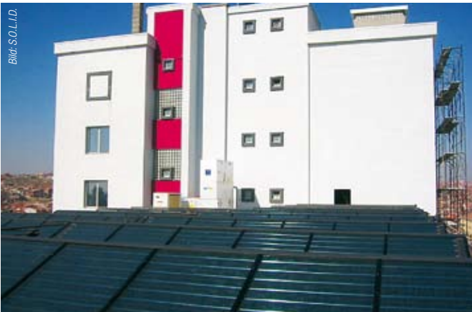
EAR-Tower in Pristina/Kosovo mit einem 227 m 2 großen Kollektorfeld für solare Kühlung. Die Normkältelieferung der zwei Absorber beträgt 90 kW.
