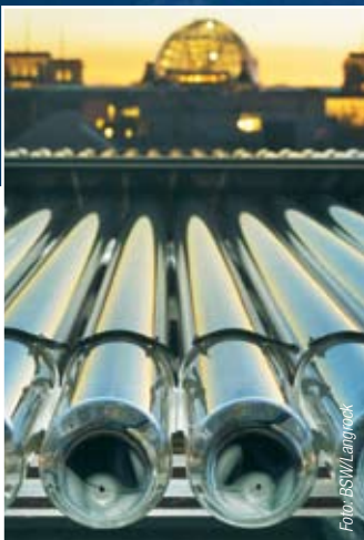
Solaranlage des Berliner Presse- und Informationsamts zur solargestützten Kälteerzeugung mit zwei Absorptionskälteanlagen.
