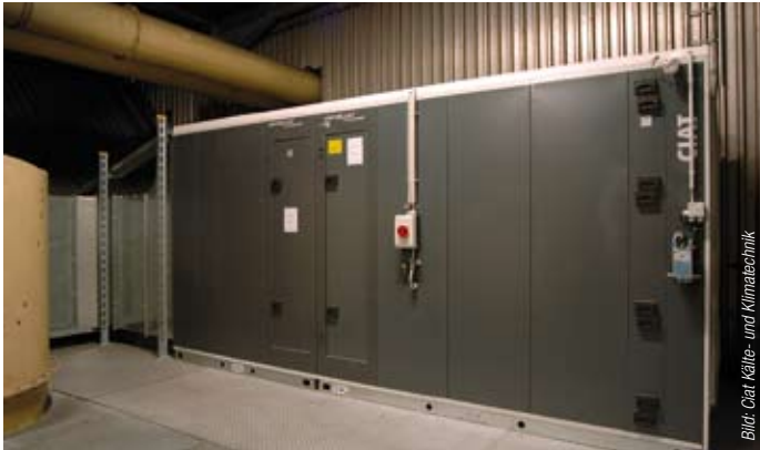
Hightech im Schrottturm: Das hier neu installierte Zentrallüftungsgerät mit Wärmerückgewinnung senkte die Betriebskosten der Halle um 40 000 Euro/a.
