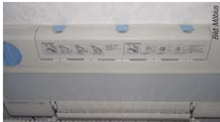
Bild 9 Ansicht des Lüftungsgeräts.
