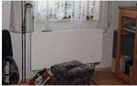
Bild 3 Montiertes Gerät im Wohnraum.
