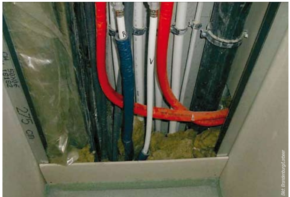
Bild 1 Rohrleitungs-bündel im Installationsschacht. Die Dämmung wurde bei der Rohranordnung „vergessen“, eine nachträgliche anforderungsgerechte auf die Rohrleitungen aufgebrauchte Dämmung nicht mehr möglich. Die Reparaturkosten dürften die ursprünglichen „Installationskosten“ übertreffen.
