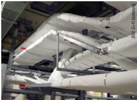
G+H Isolierung: Bandage für elektrische Leitungen.
