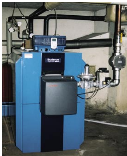
Bild 3 Der Schwerpunkt der Investitionen fiel auf Kesselerneuerungen und verbesserte Regelung
