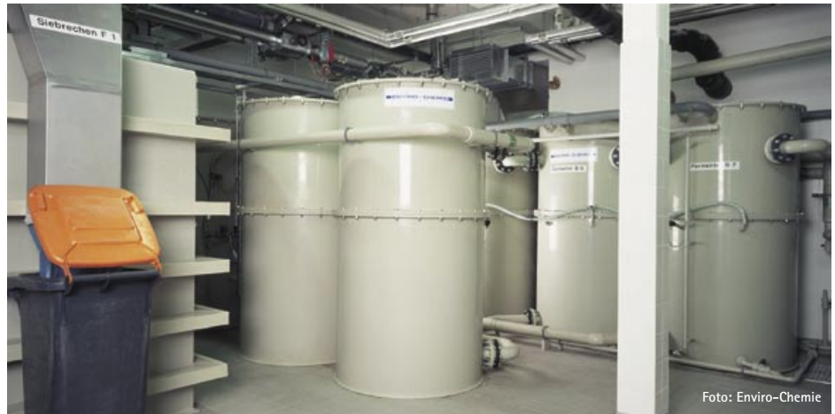
Installierte SPLIT-O-MAT FAT-Anlage mit einer Leistung von 25 m 3 /d
