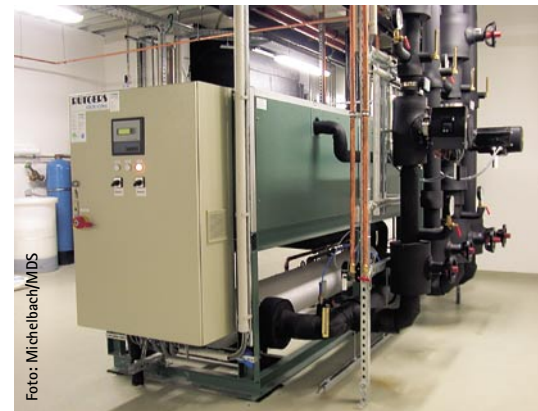
Bild 6 Die Leistung der 340-kW-Kältemaschine lässt sich im Bereich zwischen 10 und 100 % stufenlos variieren
