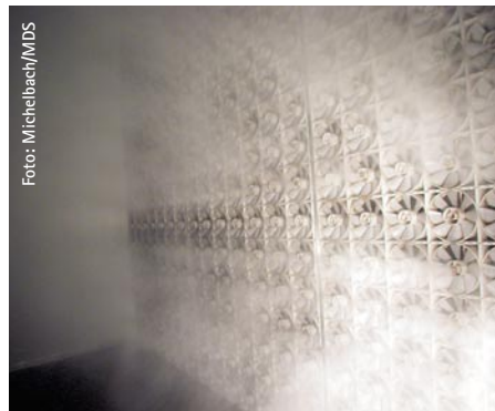
Bild 4 Die Kunst der adiabatischen Befeuchtung liegt darin, nur so viel VE-Wasser zu vernebeln, wie tatsächlich gebraucht wird. Die „Befeuchterkammer“ bleibt dabei weitgehend trocken
