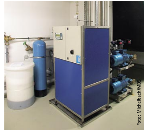
Bild 5 Umkehrosmoseanlage „LUMI-Hydrotech“ (2500 l/h) zur Aufbereitung von vollentsalztem Wasser für die adiabatische Druckwasserbefeuchtung und die Produktionsanlagen. Die Anlage arbeitet ohne Vorratsbehälter „on demand“
