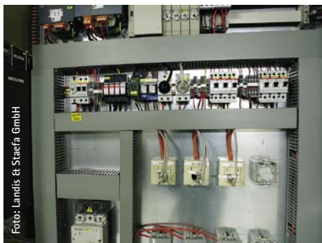
Bild 8 Schaltschrank mit BACnet-Sternkoppler (links) und Anschlussdosen für Anschluss Unterstationen über LWL-Kabel
