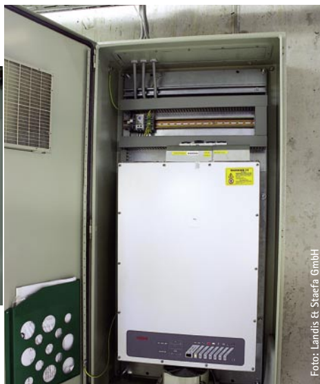
Bild 9 Die Spannungsversorgung der Router-schränke ist jeweils durch eine dezentrale USV-Anlage gegen Spannungsabfall gesichert
