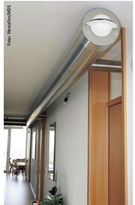
Bild 6 Damit auch am Ende des Luftverteilerelementes die Zulufttemperatur noch ausreicht, sind die Edelstahlrohre innen isoliert
