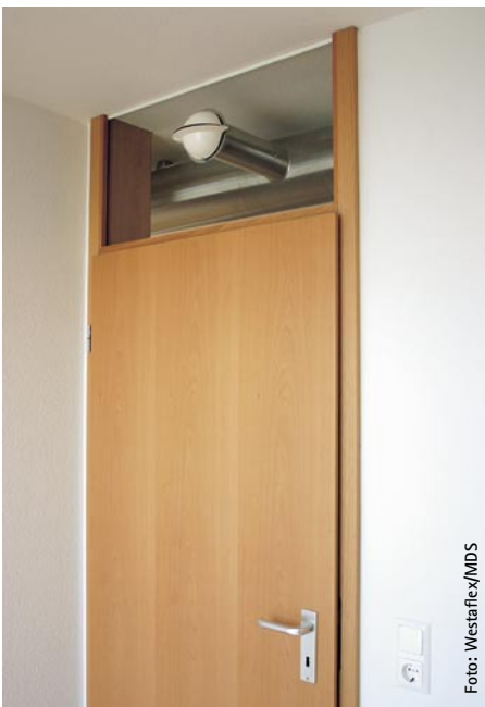
Bild 5 Präzisionsarbeit am Bau: Stichproben der Rohbaumaße sowie eine Maßschablone für den Türsetzer garantierten exakte Öffnungen in den Oberlichtern für die Edelstahlabzweige
