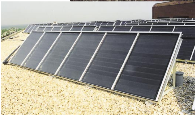
Bild 1 Kollektorfeld auf dem Flachdach der Stadtklinik Baden-Baden
