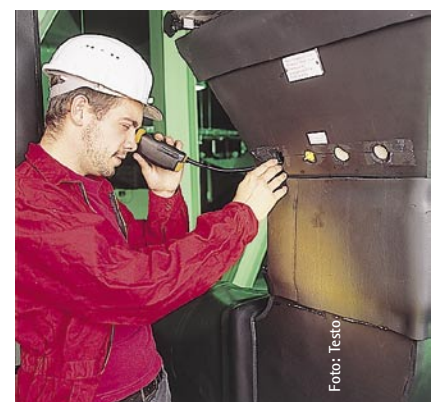
Foto: Testo Testo: Mit Endoskopen können schwer zugängliche Stellen mit minimalem Aufwand inspiziert werden
