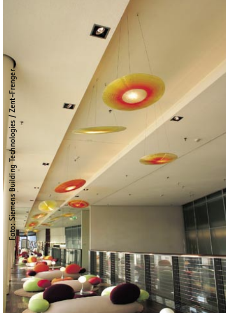
Lounge im 8.OG mit Möbel-Unikaten von Matteo Thun. Auch hier wird über die Decke geheizt und gekühlt
