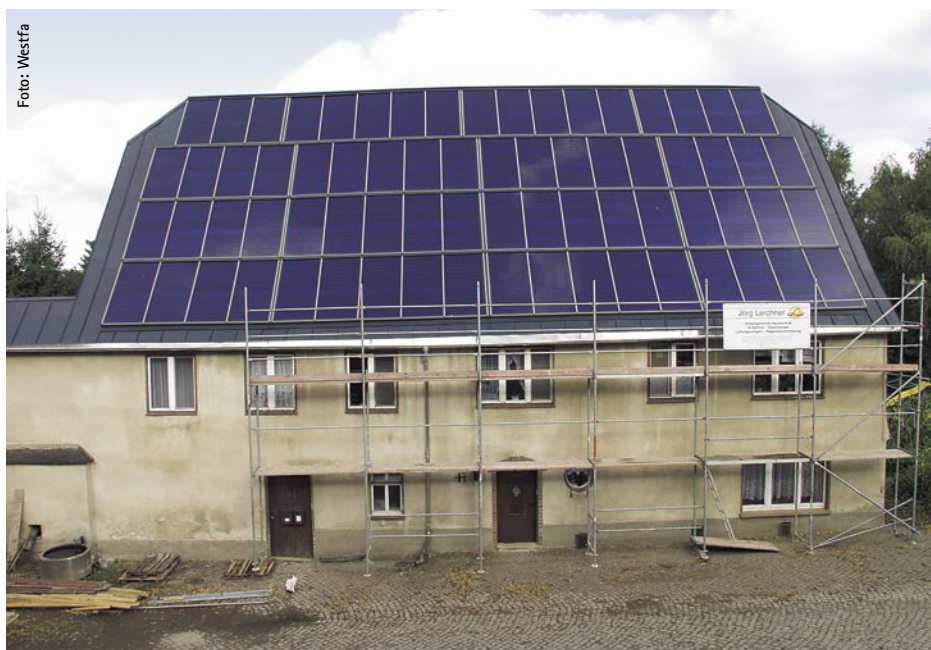
Vier Reihen mit jeweils vier Indachkollektoren in Serie geschaltet ergeben eine Bruttokollektorfläche von 144 m 2
