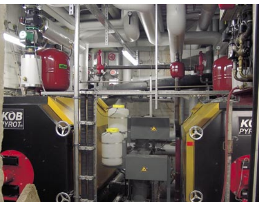
Zwei Pelletkessel mit 400 bzw. 540 kW versorgen das Kloster Schlehdorf mit Heizwärme
