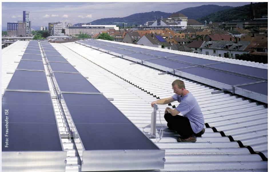
Bild 5 100-m 2 -Solarluftkollektorfeld als thermischer Antrieb einer SGK-Anlage
