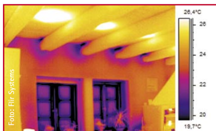
Bild 1 Eindringen von kalter Luft bei einem Blower-Door-Test
