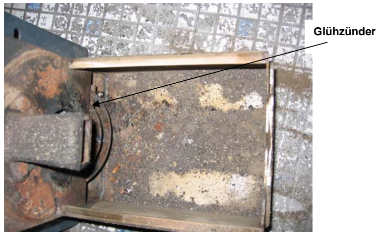
Abb.: Verbrennungsrückstände und Ablagerungen in der Brennerschale.
